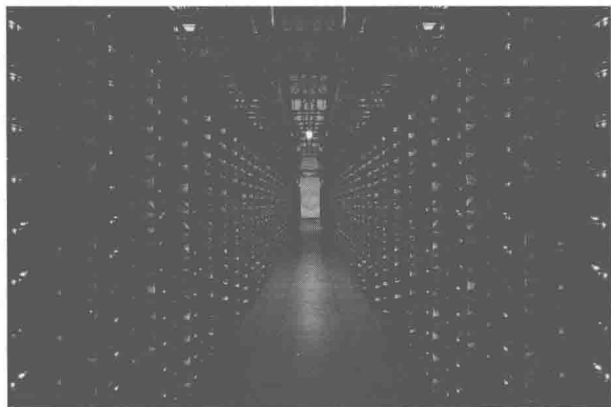
图 32.2 Google 在北卡罗莱纳州的数据中心，图中任意一个机柜的存储量都超过了美国国会图书馆的文字内容
